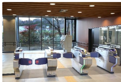
東西線自動出改札設備
